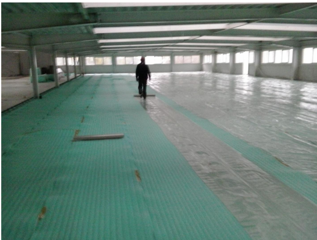
Obr. 47 Názorná ukázka Varianty 3, pokládka Ethafoamu a separační Pe - folie na stropě výrobní haly
