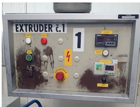
Obrázek 12: Poškozený panel stroje
