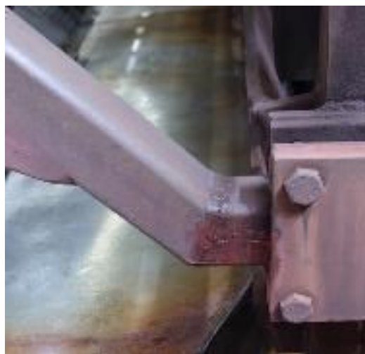
Obrázek 30: Opravená prasklina na vozíku
