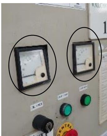
Obrázek 11: Poškozené indikátory uvolnění
