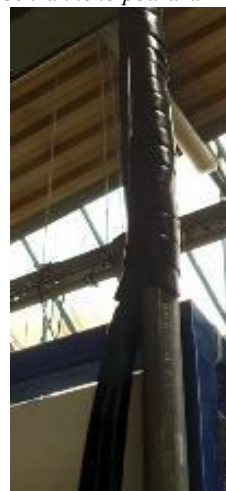
Obrázek 59: Schované kabely do ochranného pouzdra
