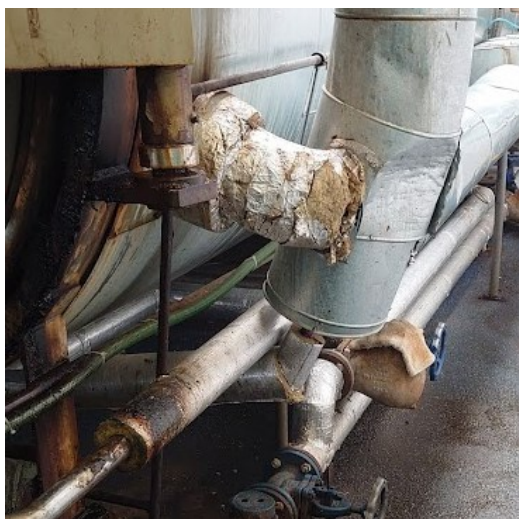
Obrázek 33: Špatná izolace potrubí
