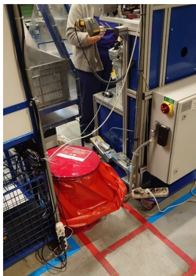
Obrázek 57: Volně visící kabely
