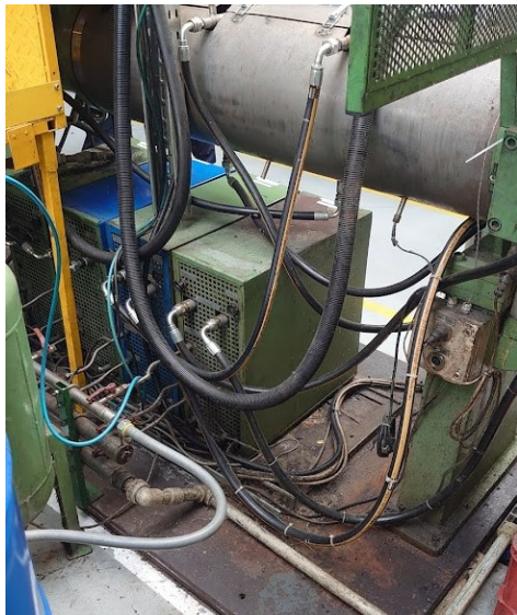
Obrázek 9: Náhodné umístění kabelů a hadic + koroze krytů topných zařízení
