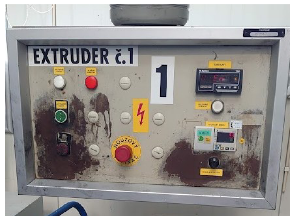
Obrázek 12: Poškozený panel stroje
