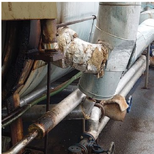
Obrázek 33: Špatná izolace potrubí
