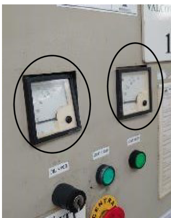
Obrázek 11: Poškozené indikátory uvolnění
