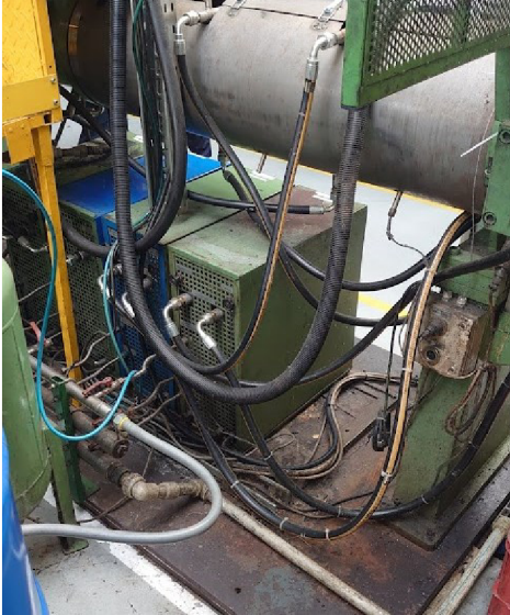
Obrázek 9: Náhodné umístění kabelů a hadic + koroze krytů topných zařízení
