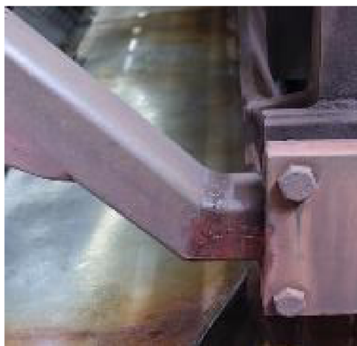
Obrázek 30: Opravená prasklina na vozíku
