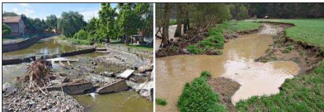
Obrázek 9: Poškození koryta vodního toku zvýšenými povodňovými průtoky (Just et al., 2020), úprava autor.
