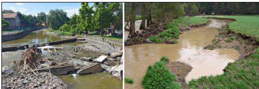
Obrázek 9: Poškození koryta vodního toku zvýšenými povodňovými průtoky (Just et al., 2020), úprava autor.
