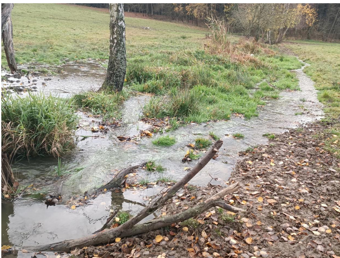
Obrázek 3.1: Zanešené koryto (zdroj a zpracování: vlastní)
