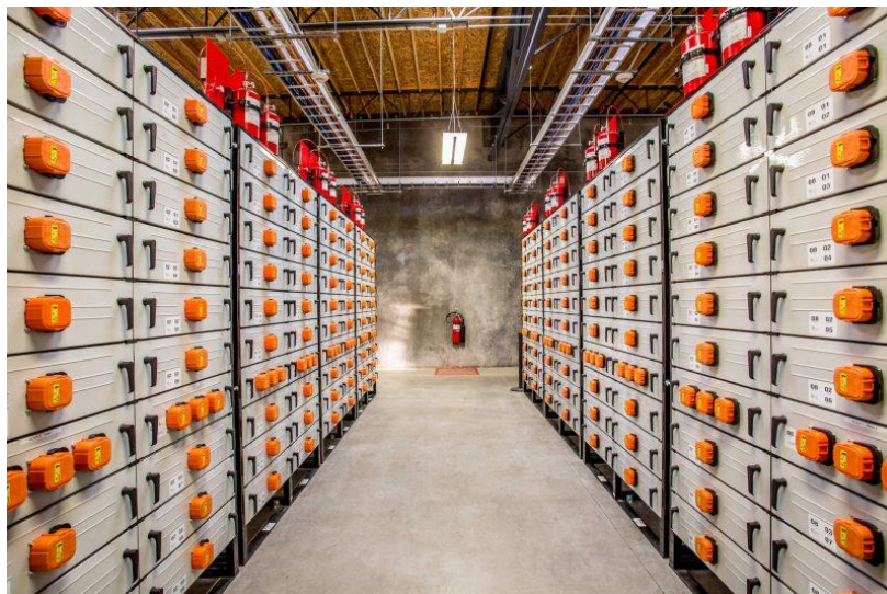
Obrázek 11: Bateriové úložiště, Prisma Energy Capital [30]
