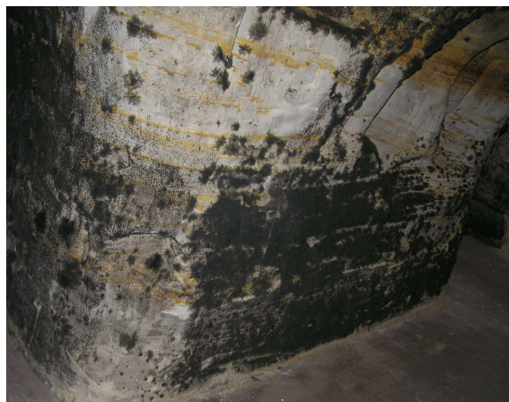
Obr.č. 9 Stěny Modrého sklepa pokryté ušlechtilou plísní Cladosporium Cellare
