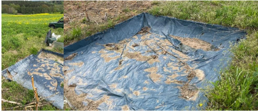
Obrázek. 6, 7: geotextilie v sedimentačních jímkách poškozená hlodavci – stav před opravou
