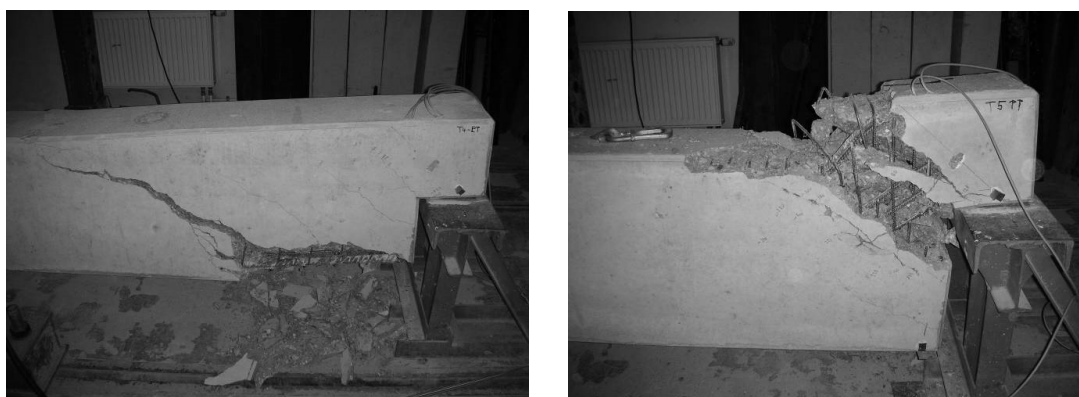
Obr. 6.7 Porušení zhlaví E (vlevo) a A2 (vpravo)
