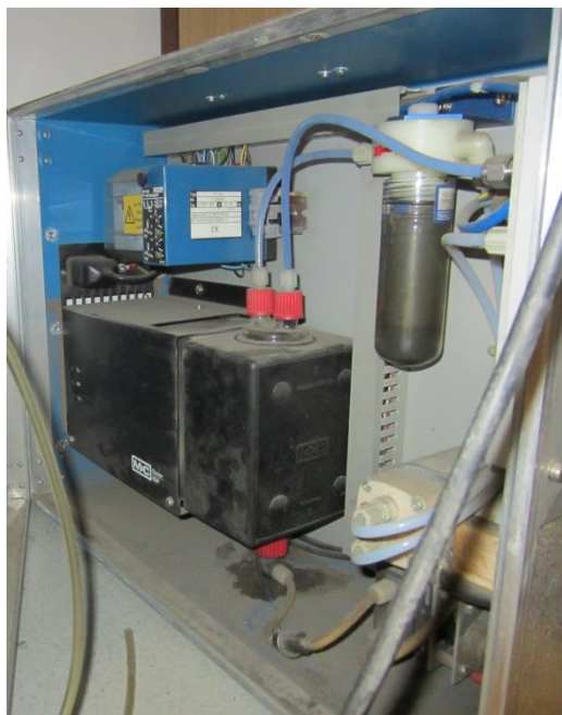
Obr. 16 Zřízení na úpravu spalin
