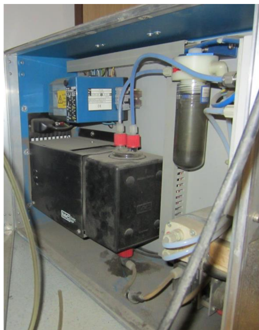
Obr. 16 Zřízení na úpravu spalin
