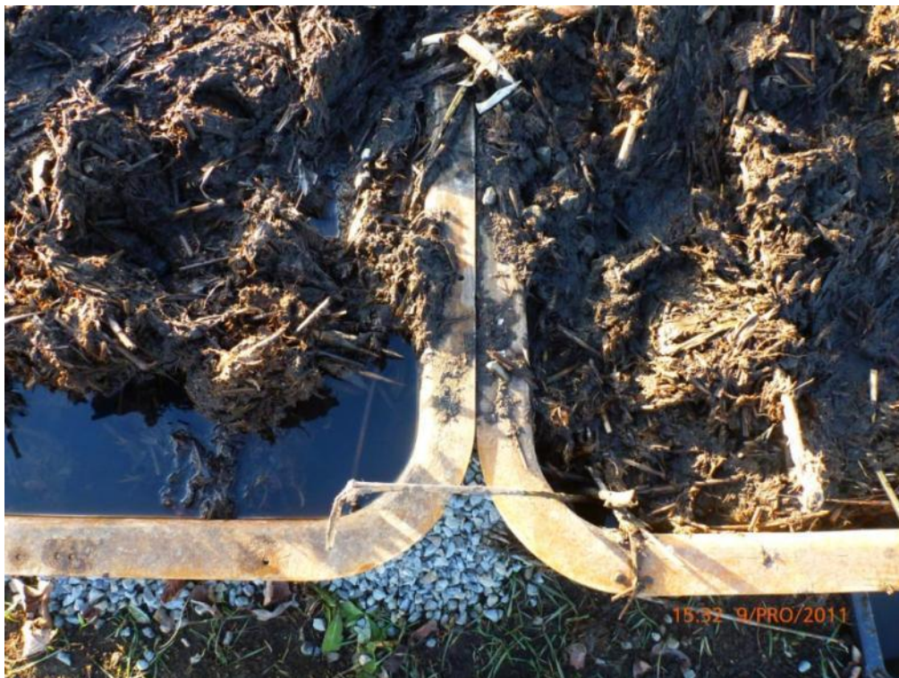
Obr. 14-15 Ukázka fungujícího odvodnění u pravého lyzimetru
