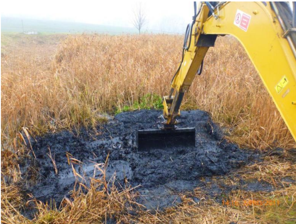
Obr. 14-10 Odběr vyplaveného kalu v nejvíce zasaženém místě (hloubka kalu 28 cm)
