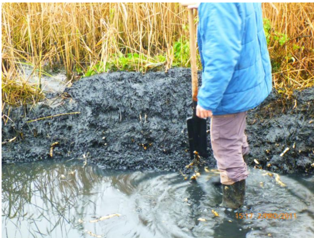
Obr. 14-22 Těžbu materiálu znesnadňuje přítomná odpadní voda ve filtračním prostředí
