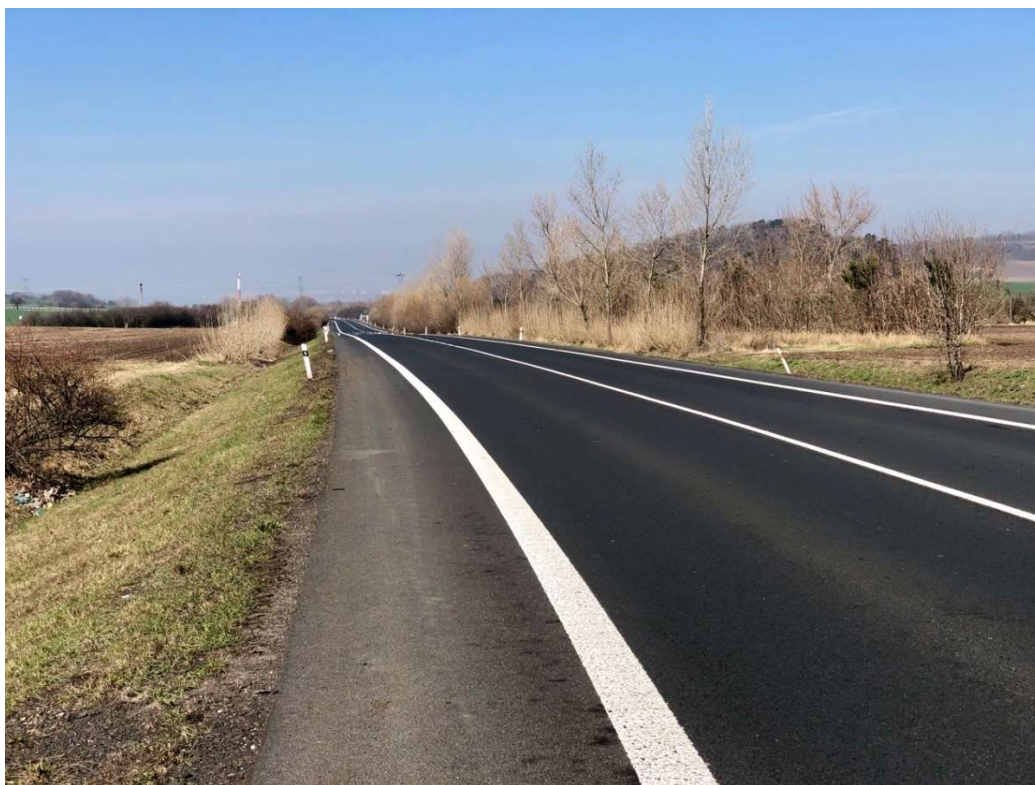
Obr. č. 30: Silnice I/28 mezi obcemi Bělušice a Odolice (autor: Jiří Popper, 2018)
