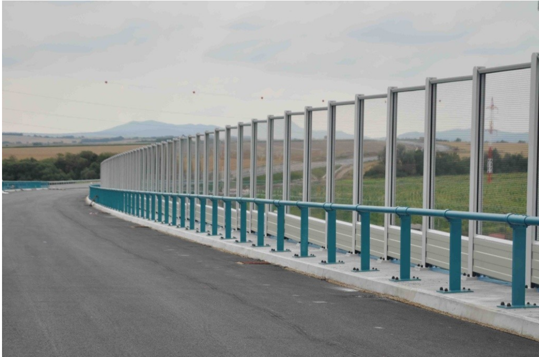
Obr. č. 7: Prosklená protihluková stěna (Aerolux)
