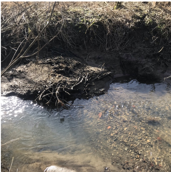
Foto 66: pohled na vymílané koryto
