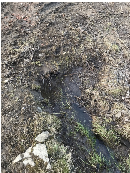
Foto 133: pohled na poškozené zatrubnění pod tunelem
