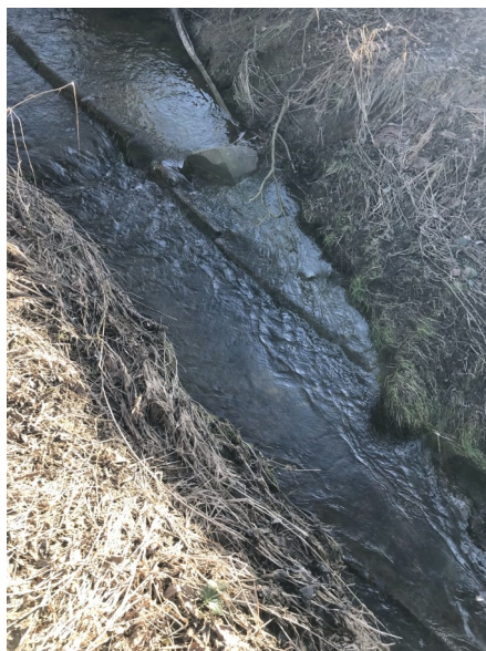
Foto 111: pohled na poškozené opevnění dna
