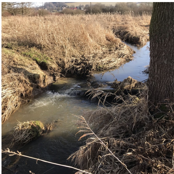
Foto 81: pohled na poškozené opevnění
