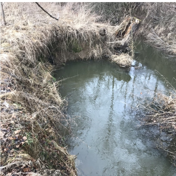
Foto 17: pohled na vymílání levého břehu
