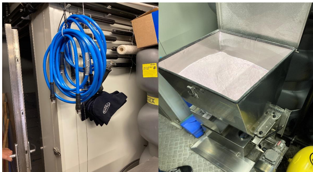
Obrázek 15: Plynový kotel + dávkovač prášku
