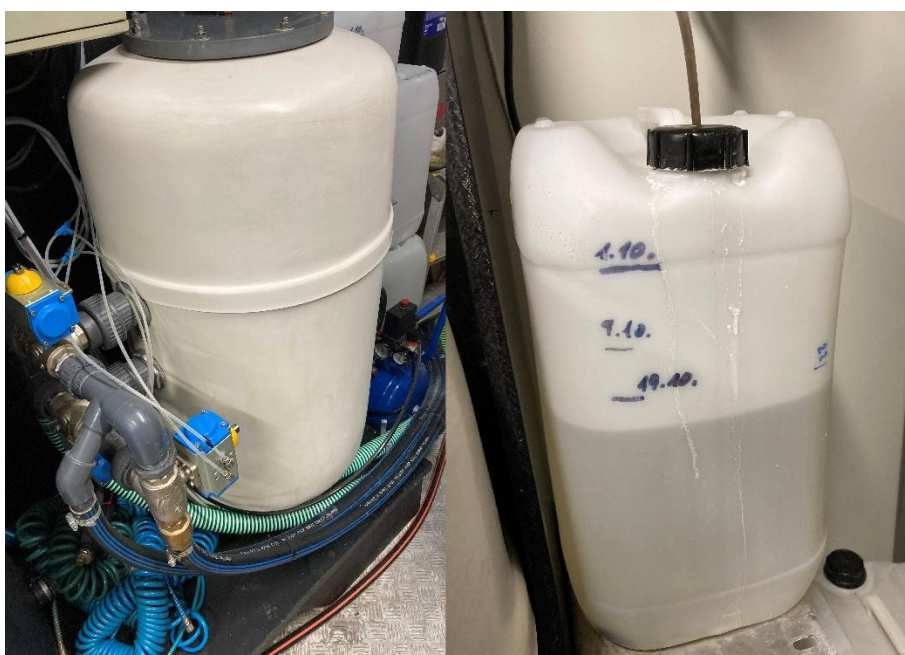
Obrázek 20: Vodní nádrž s filtračním pískem + koagulant
