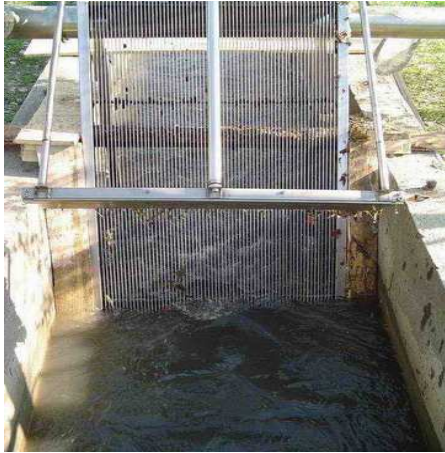
Obr. 2 Česle strojně stírané
