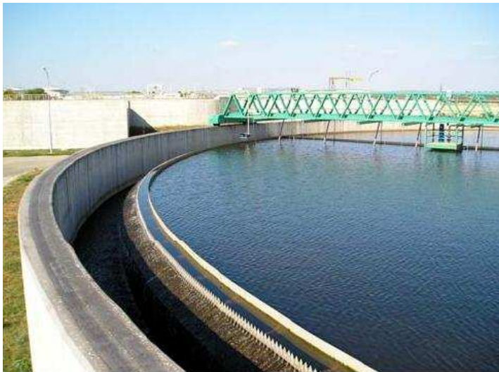
Obr. 5 Dosazovací nádrž (ČOV Modřice)
