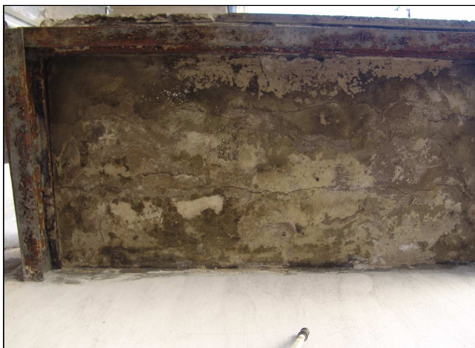
Obr. 26 Vyšší míra odpadu omítky spodního líce balkonu v 3.NP a koroze ocelových nosníků konzol.
