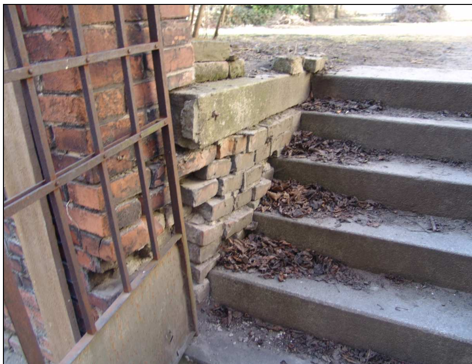
Obr. 138 Vyboulená a rozpadávající se zídka venkovního schodiště.
