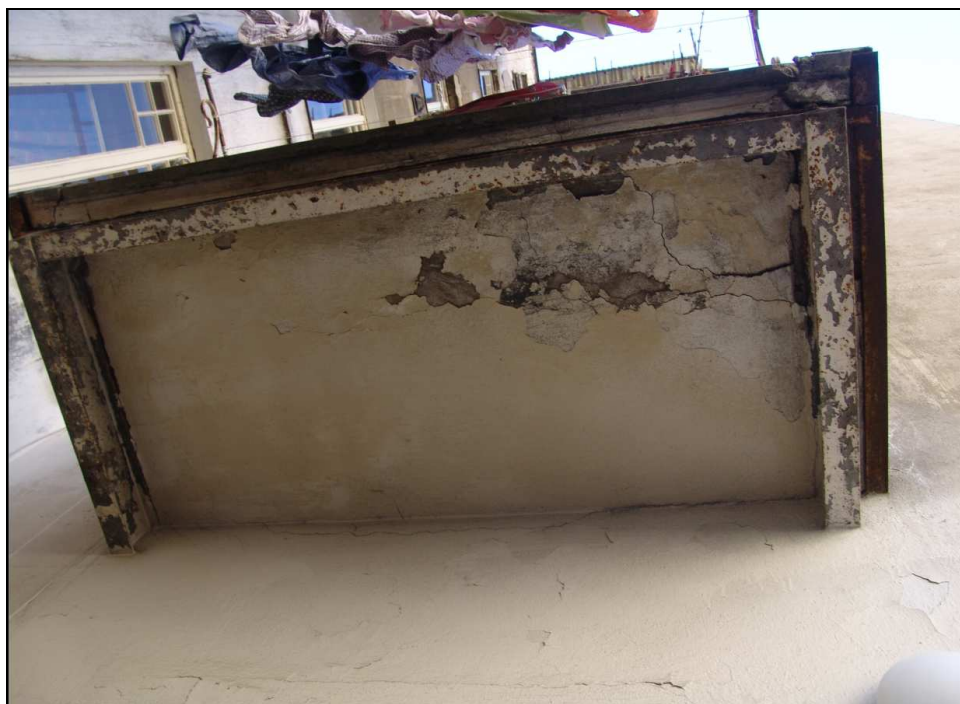
Obr. 149 Odpad omítky spodního líce balkonu v 1.NP a koroze ocelových nosníků konzol.
