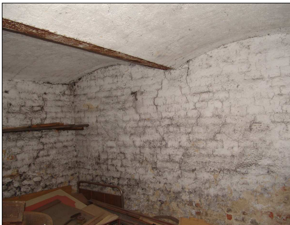
Obr. 131 Povrchová koroze na I-profilech, do kterých jsou osazeny klenby a trhliny v povrchové úpravě cihelného zdiva.
