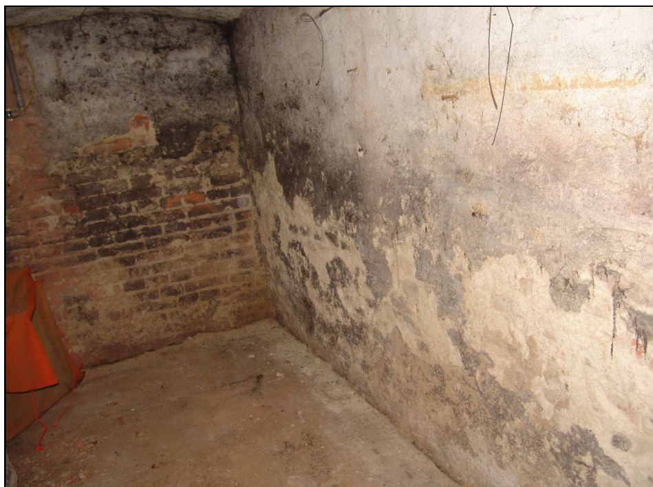
Obr. 130 Zavlhlé cihelné zdivo, lokální odpad omítky.
