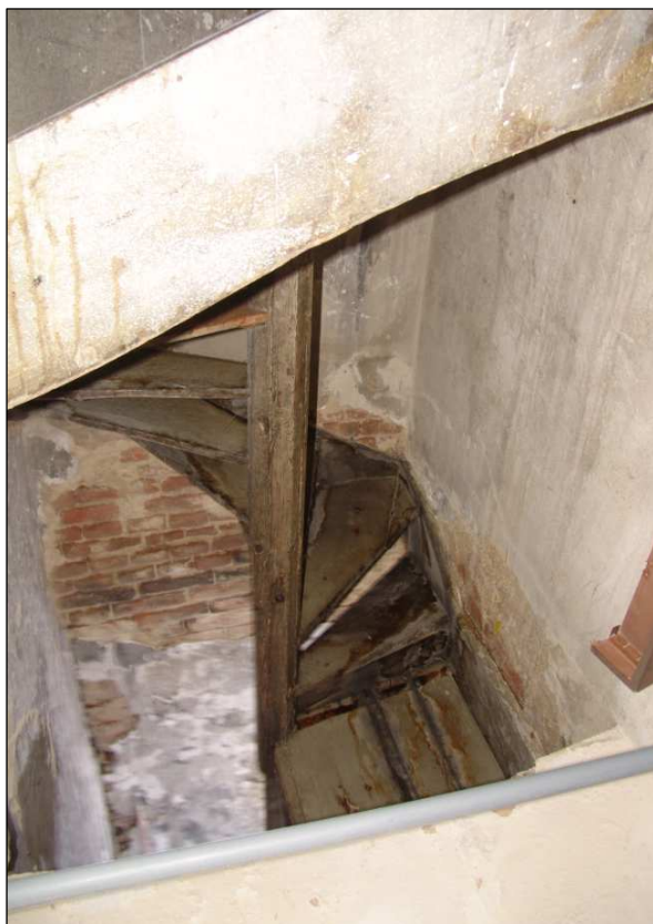
Obr. 85 Schodiště sloužící k výstupu na plochou střechu, bez zábradlí a s provlhčenými, lokálně ztrouchnivělými nášlapnými vrstvami.
