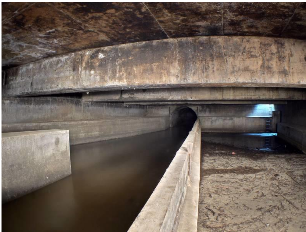
Obrázek 2.3 - Odlehčovací komora na kmenové stoce B, ulice Opuštěná v Brně [10]
