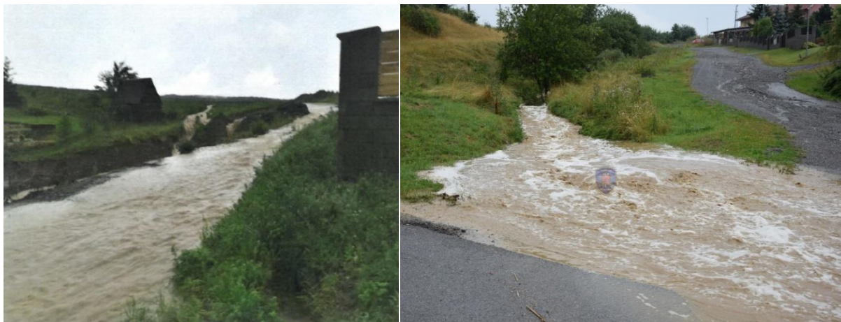
Obrázek 5.28 - Povrchový odtok extravilánových vod u ZP 2 následkem přívalové srážky ze dne 20.6.2019 (vlevo) a ucpaný propustek (vpravo) [45]
