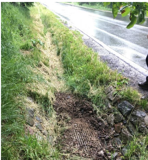
Obrázek 5.24 - Mříž po odkrytí nánosu na nátoku do propustku o DN 500 pod II/379
