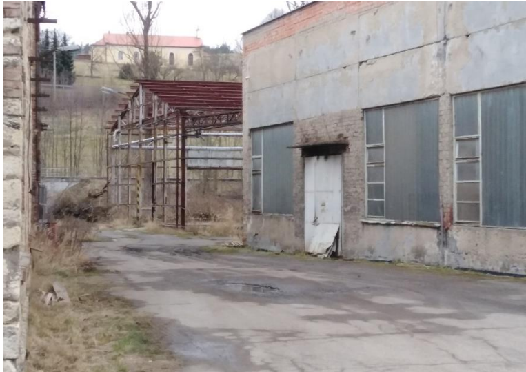
Obrázek 36: Konstrukce haly (odcizené opláštění) vlastníkem p. Bárta (Davídek 2023).
