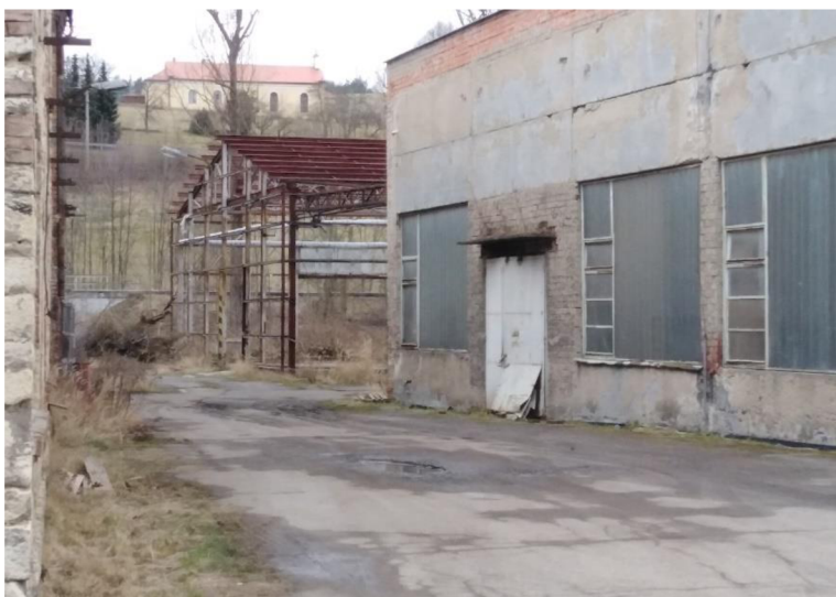
Obrázek 36: Konstrukce haly (odcizené opláštění) vlastník p. Bárta (Davídek 2023).
