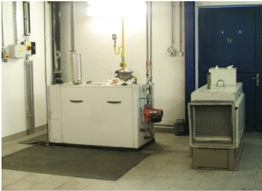
Obr. 4 Kogenerační jednotka se spalovacím motorem
