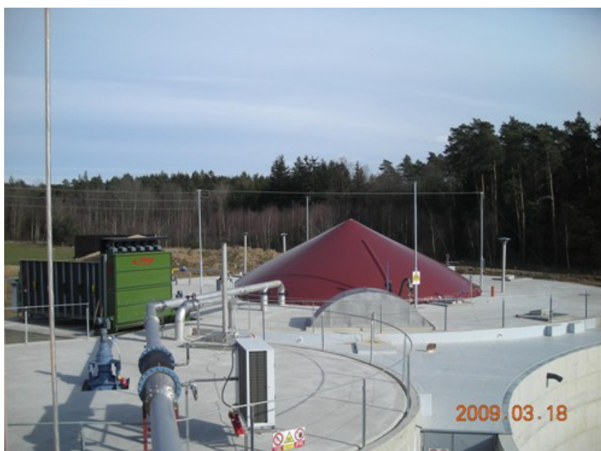
Obr. 8 Bioplynová stanice Vejprnice [25]
