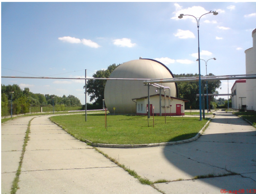
Obr. 2 Plynojem při čistírně odpadních vod [8]
