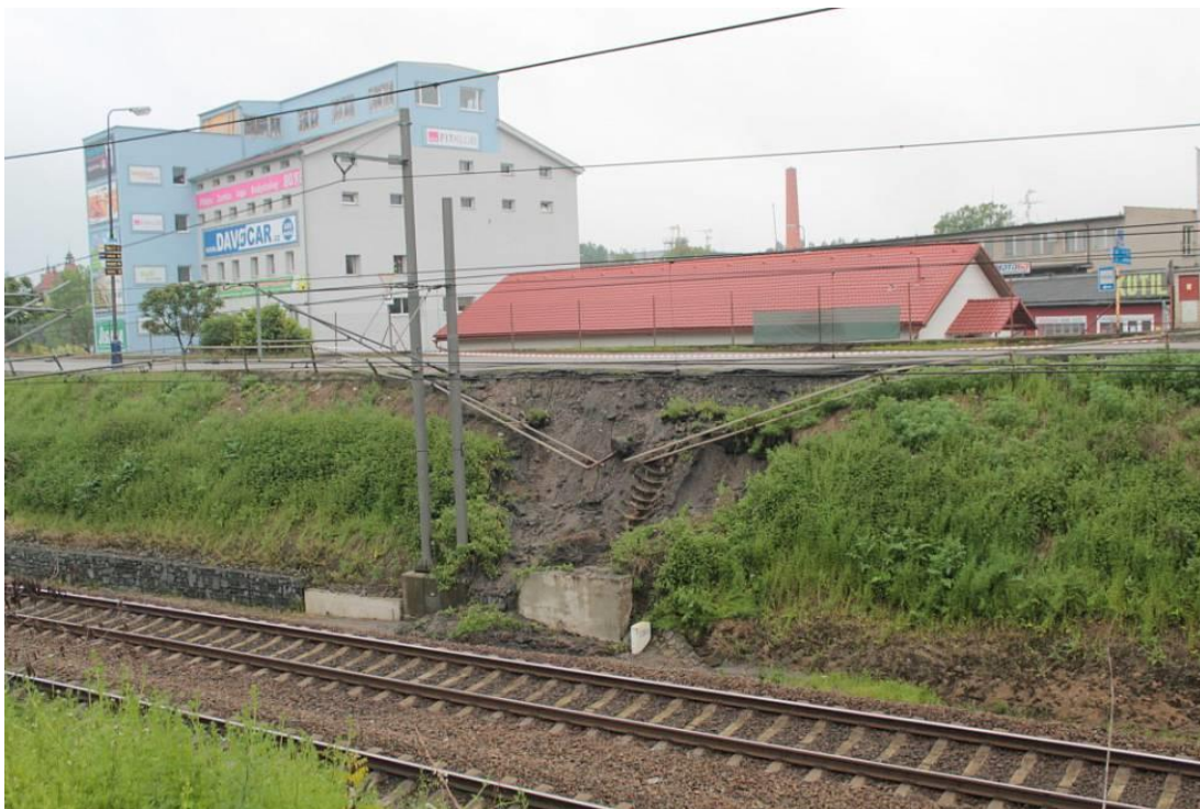
Obr. č. 30: Benešov. Sesunutý svah s chodníkem. U paty svahu viditelná zídka z gabionů (URL 9)
