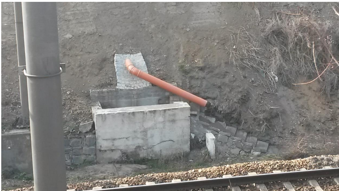
Příloha č. 4: Benešov. Vyústění drenážní trubky do vývarové jímky u paty svahu (vlastní foto, březen 2014)
