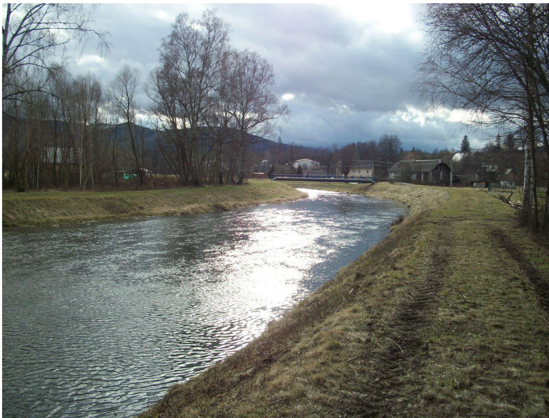
Obr. 22 – Technicky upravené koryto pravidelným lichoběžníkovým profilem v prostoru vzduť na jezu v ř.km 5,538
