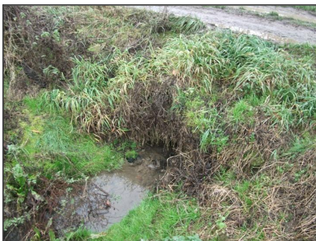
Obr. 59 Zanešený propustek. Foto: KOVÁŘ Ondřej, 2013.
