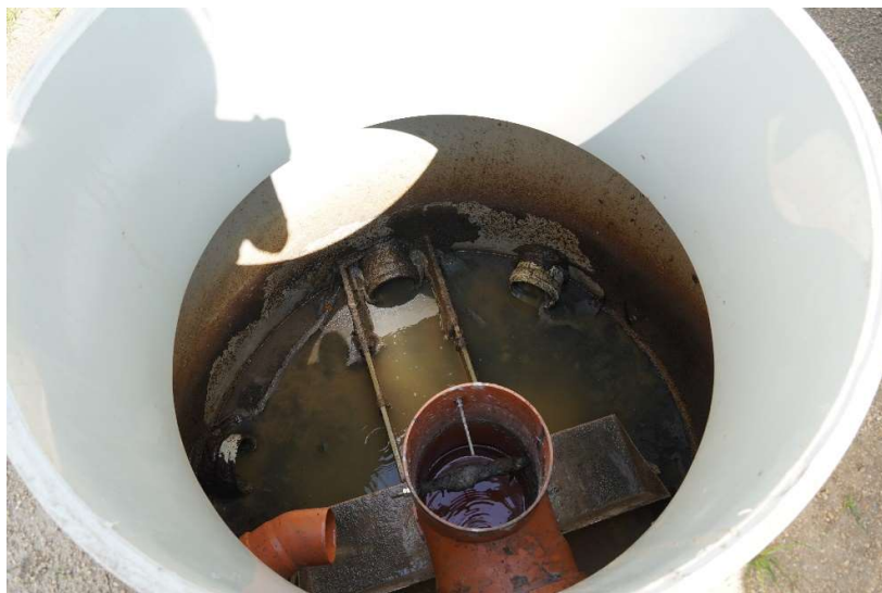
Obr. č. 43: Rozdělovací šachta před anaerobními separátory v obci Hlína
