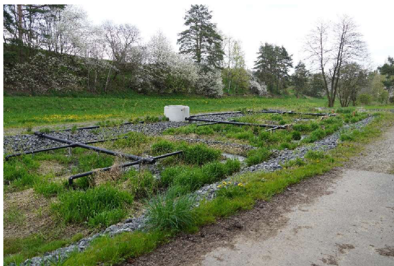
Obr. č. 10: Pohled na kalové pole French systému v Bukově
