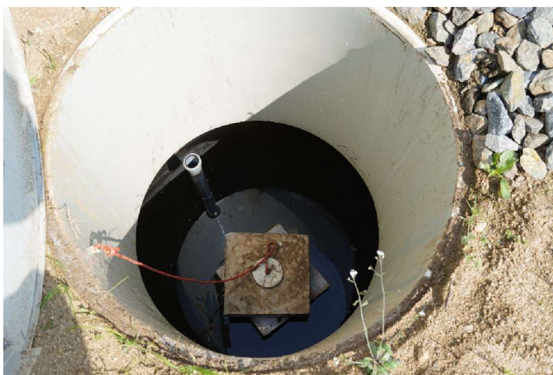
Obr. č. 23 Pulzní vypouštěč na vertikální filtr v obci Hlína
