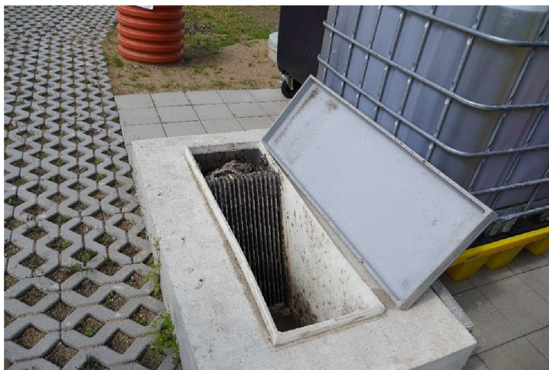
Obr. č. 13: Hrubé česle ručně stírané v obci Hlína
