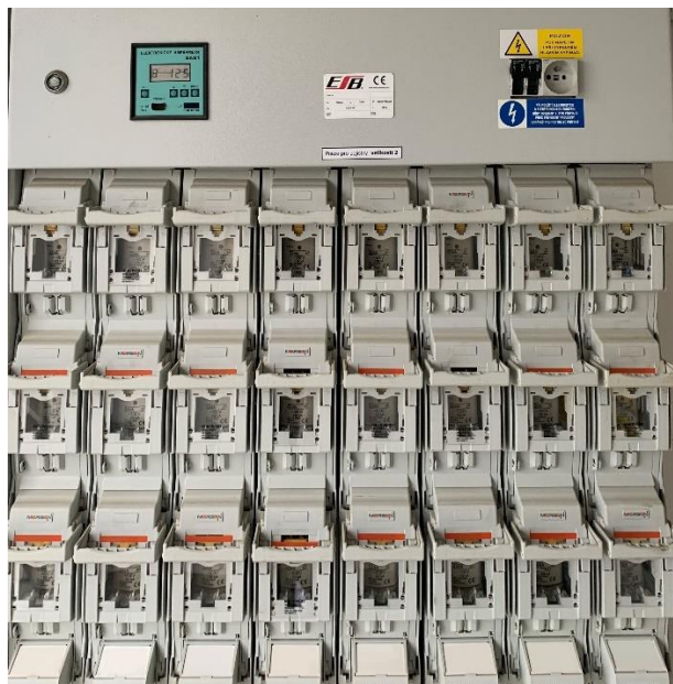
Obrázek 7.2 Rozváděč NN v TS
