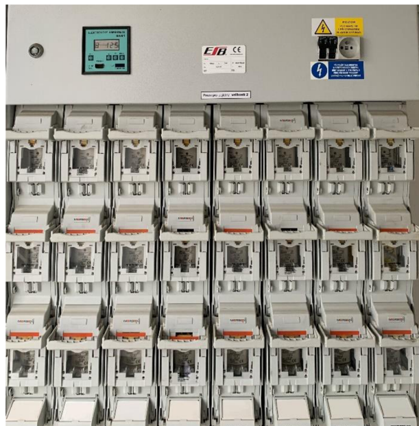
Obrázek 7.2 Rozváděč NN v TS
