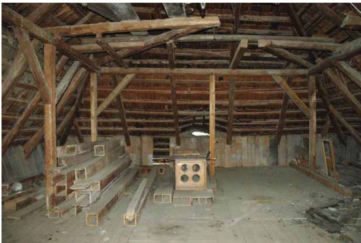
obr. 16/1 – Krov před opravou (foto Pešta 2006).
