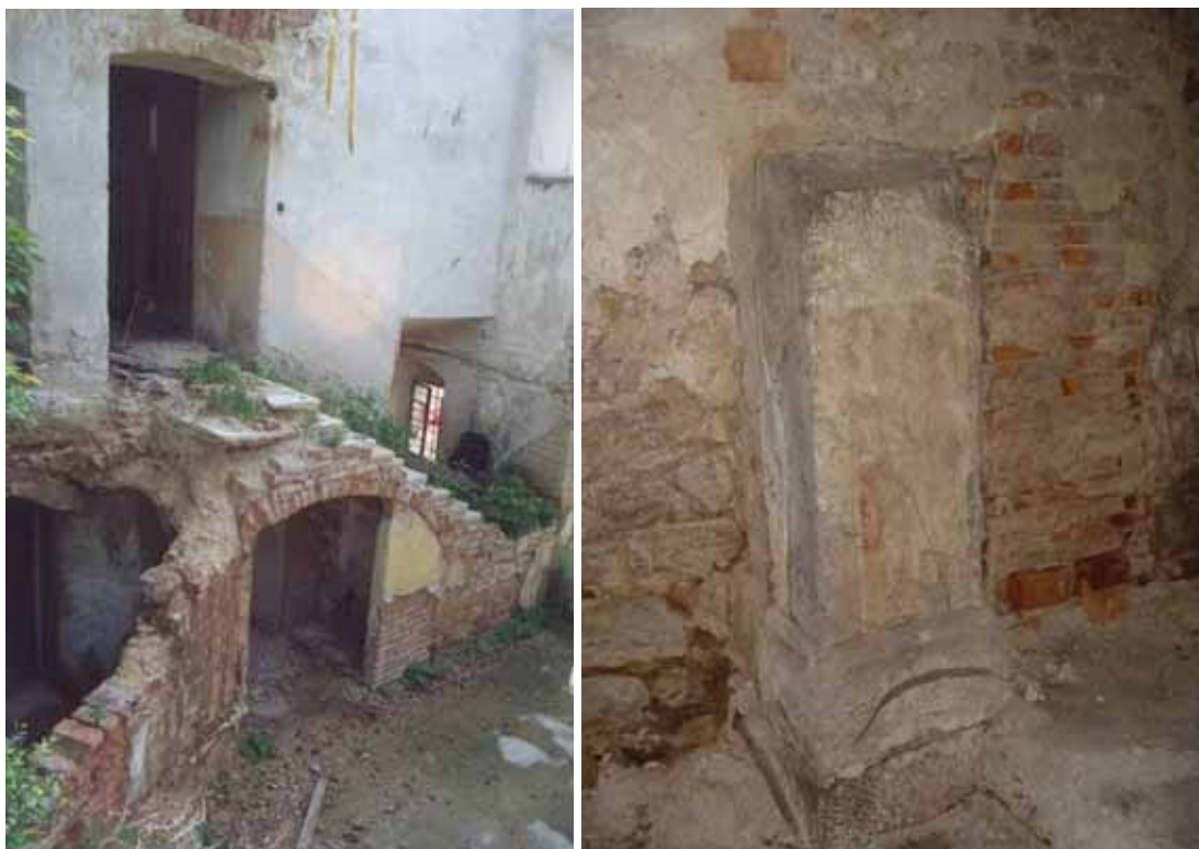
obr. 28/22 – Dnes zničené schodiště z obytné části do mlýna (foto Pešta 2000).
