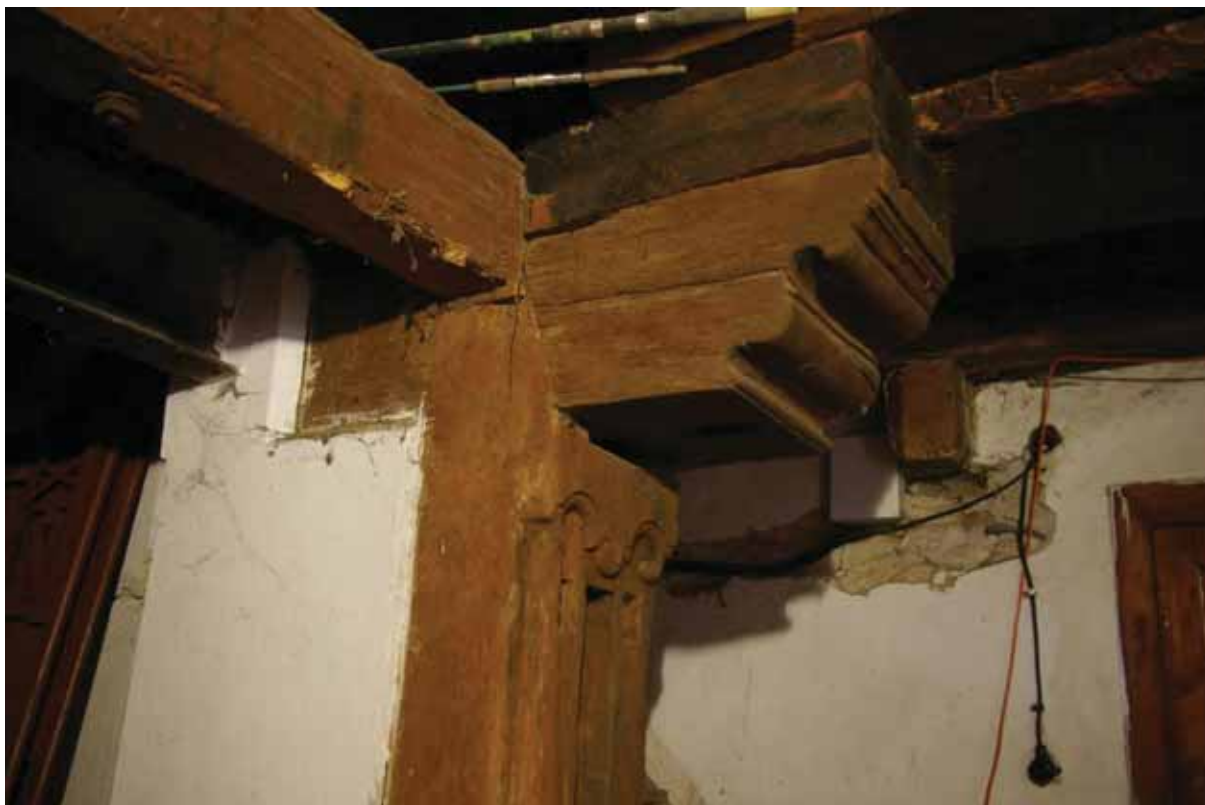
obr. 12/20 – Detail zhlaví svoru (foto Matějček 2011).
