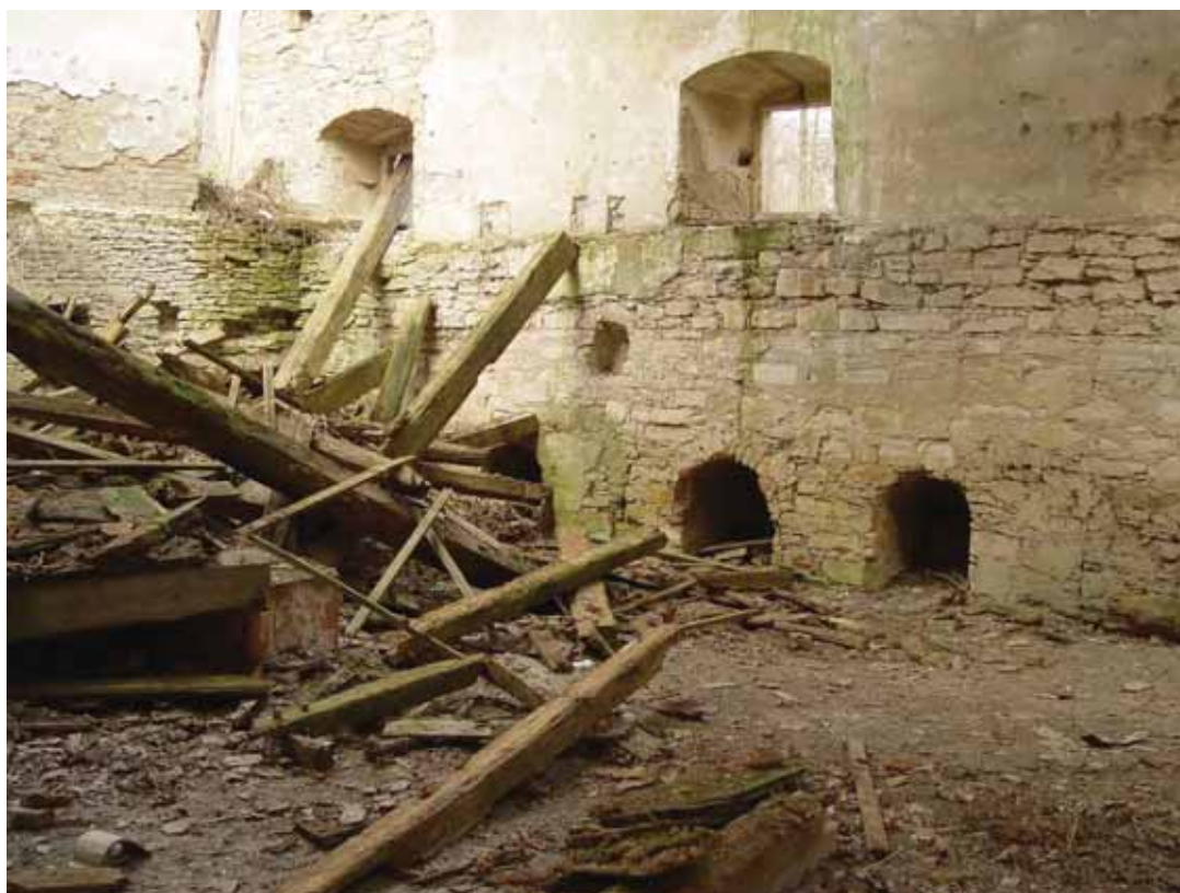
obr. 19/6 – Přízemí mlýnice s několika vně zazděnými prostupy pro hřídele vodních kol (foto Šimek 2011).
