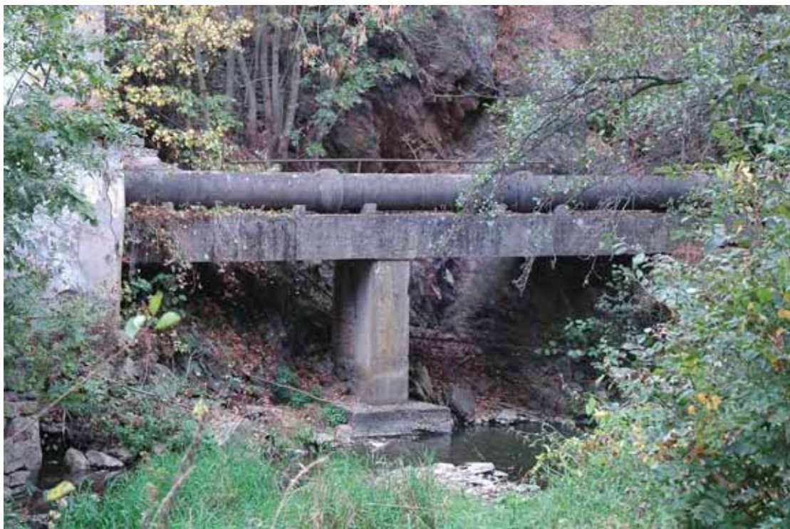
obr. 21/1 – Náhon vedený v betonových troubách (foto Pešta 2006).
