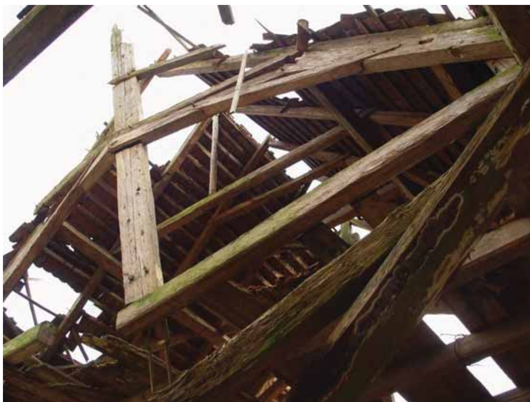
obr. 20/6 – Pohled do chátrajícího krovu (foto Šimek 2011).
