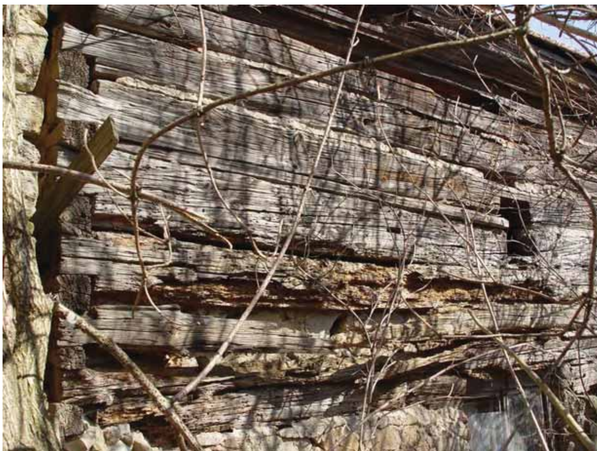
obr. 13/21 – Vážně poškozená roubená stěna (foto Šimek 2011).
