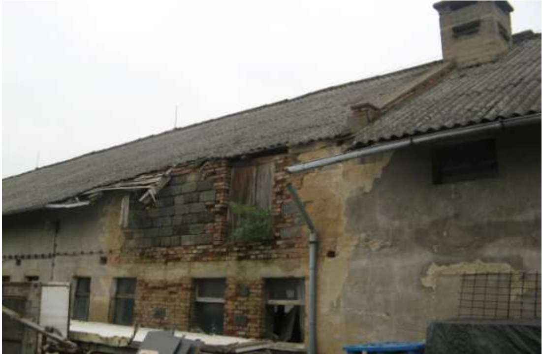
Foto č. 7: Pohled na chátrající část kravína
