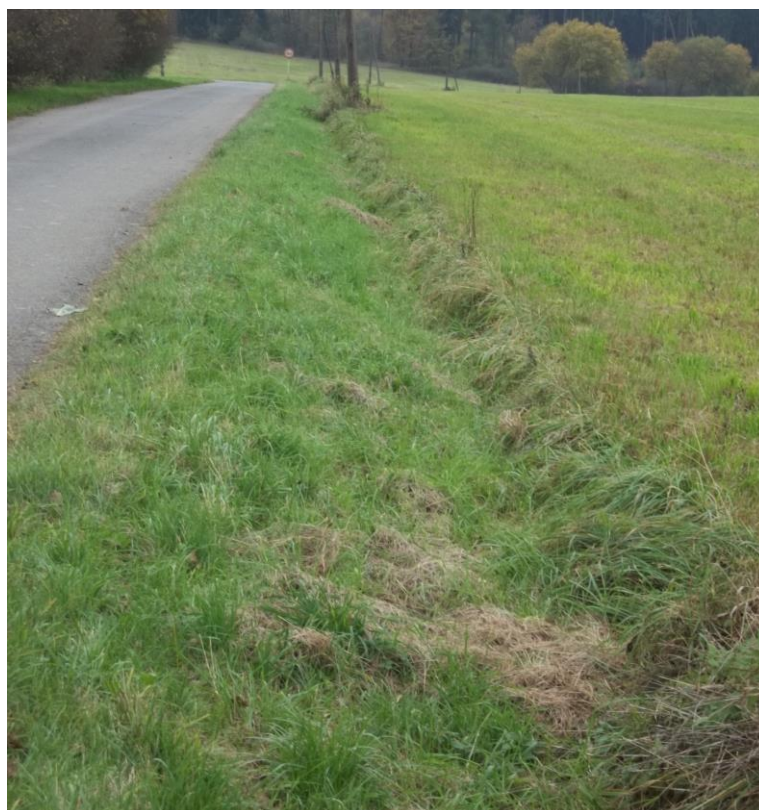
Foto č. 4 – Nutná úprava svodného příkopu (Zdroj: vlastní, 2014).
