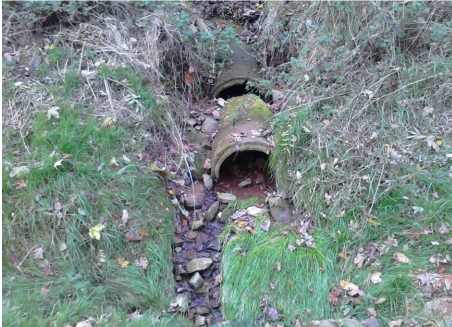
Foto č. 5 – Nutná úprava svodného potrubí (Zdroj: vlastní, 2014).
