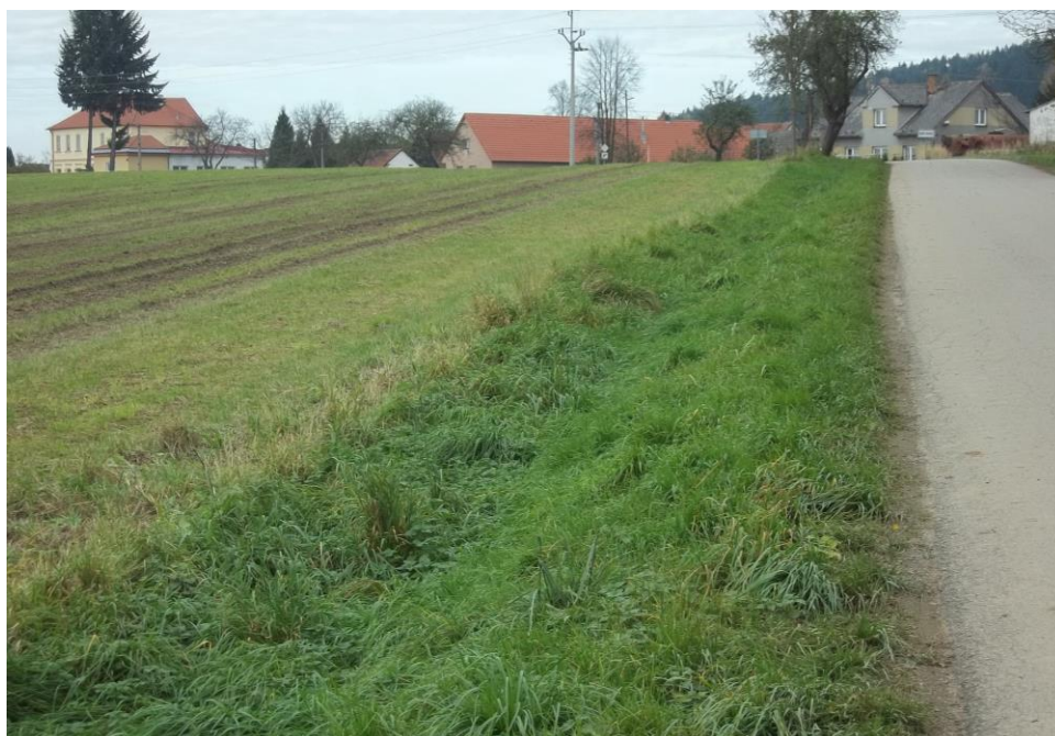
Foto č. 2 – Nutná úprava svodného příkopu (Zdroj: vlastní, 2014).
