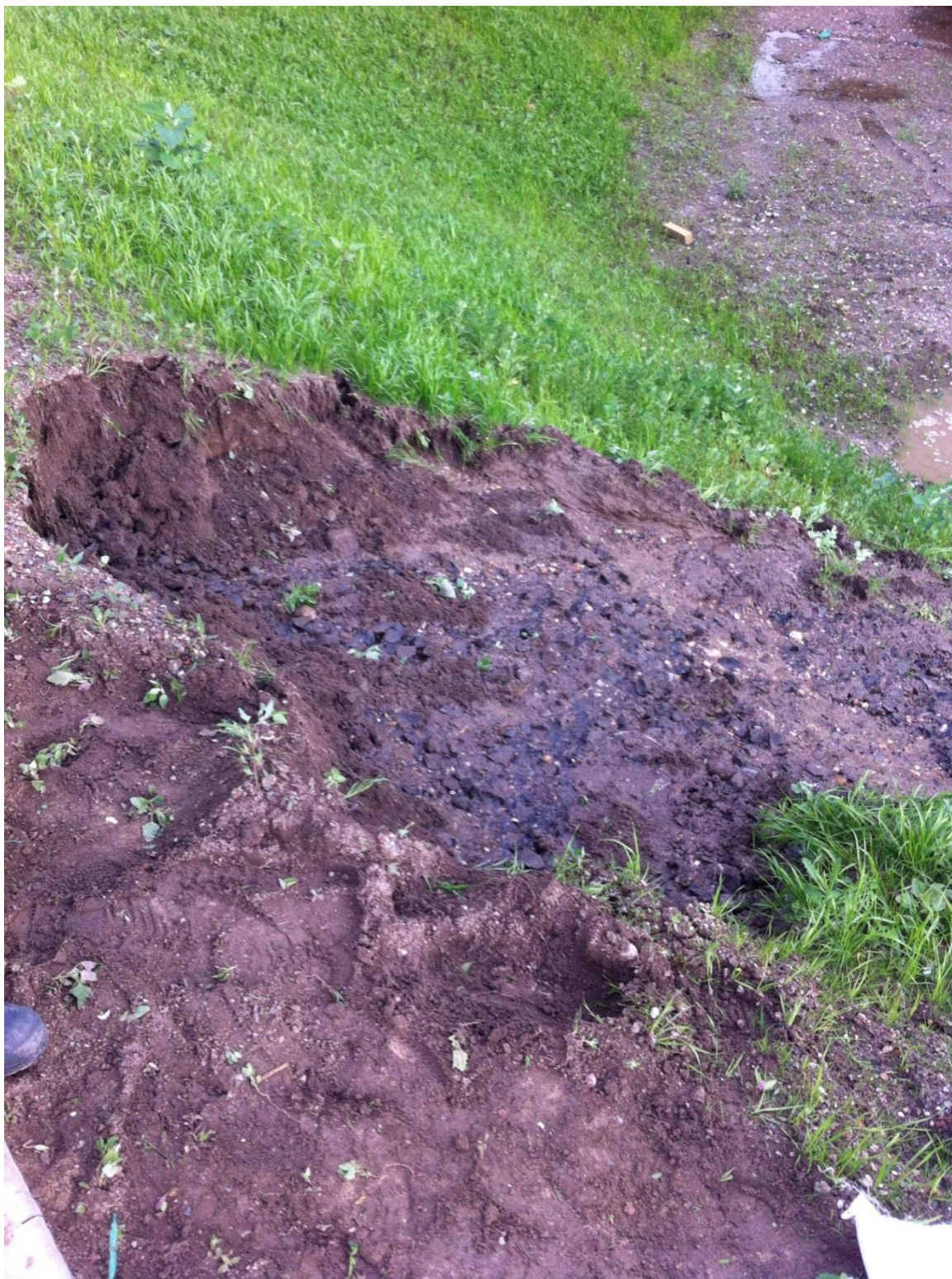
Příloha S, Trhlina – průsak v hrázi – Mělník.(archiv HZS Mělník)
