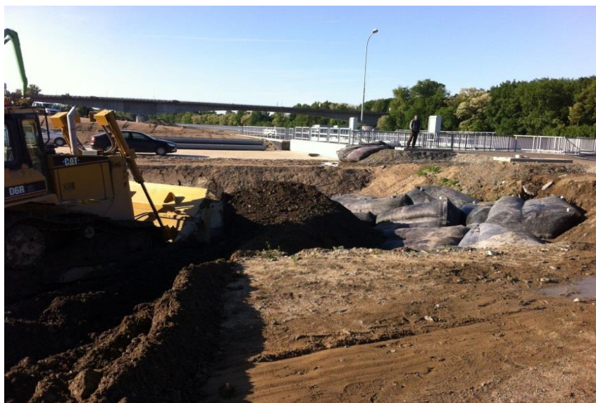
Obrázek 10, Zpevňování hráze (archiv HZS Mělník)
