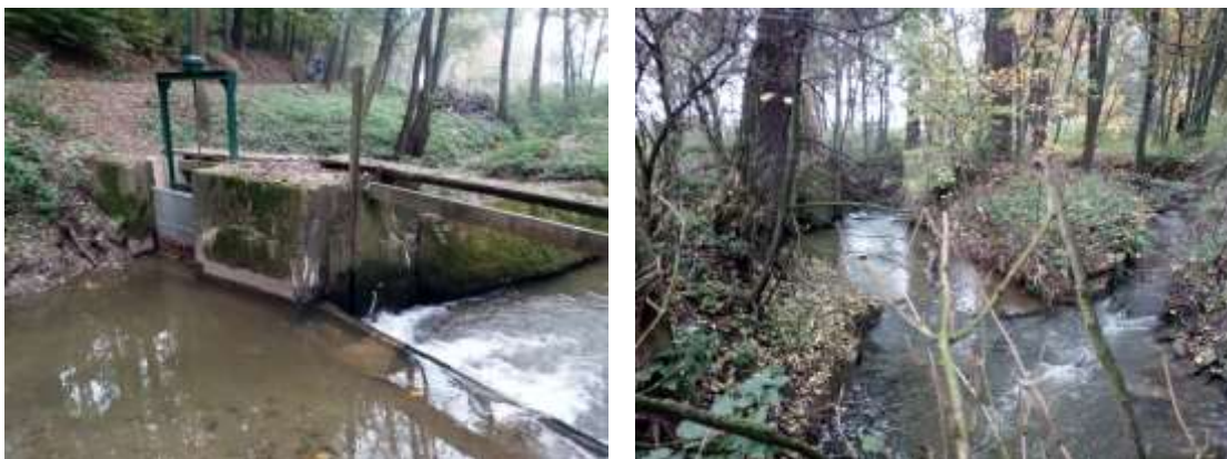
Obrázek 31 - odběrný objekt a zaústění Polického rybníka (zdroj: archiv autora)
