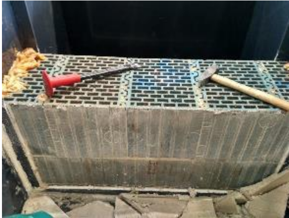
Obr. 58 Lícová strana konstrukce z mokré strany po vypuštění nádrže a odsekání povrchové úpravy
