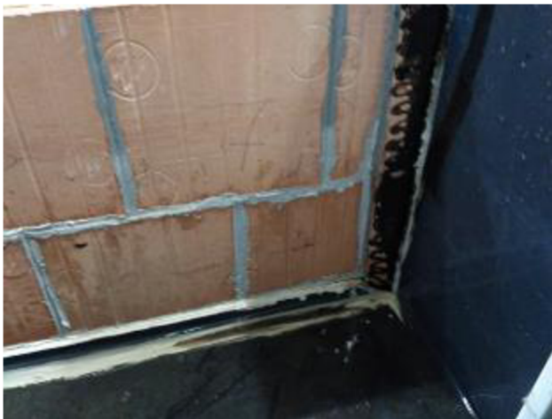
Obr. 50 Lícová strana konstrukce z mokré strany po 1 h od vyčerpání strany
