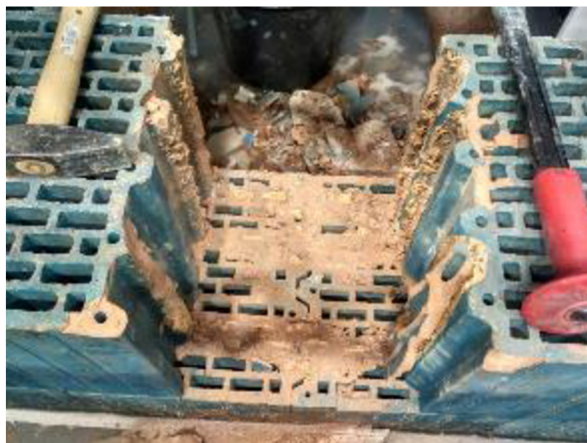
Obr. 59 Stěna po odsekání tvarovky za účelem odebrání vzorků pro stanovení vlhkostních profilů
