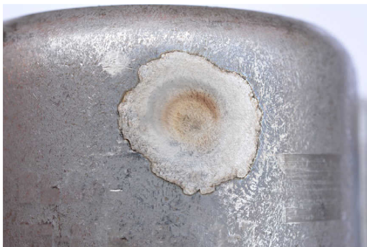
Obr. 55 Narušená povrchová úprava na plechu objímky
