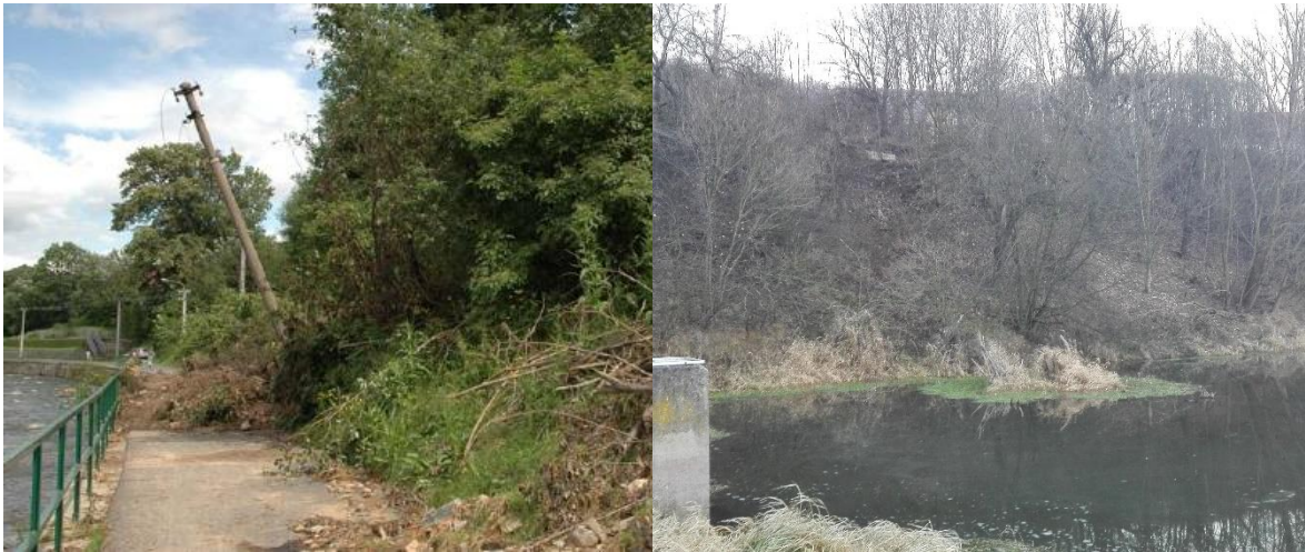
Obrázek 21: Svahové nestability č. 19 a 20 po přivalových deštích v roce 2009 Zdroj: ČGS, 2009
