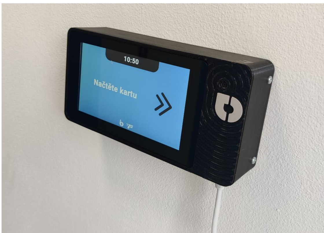
Obrázek 12.2 Nainstalovaný terminál v budově „dílna“
