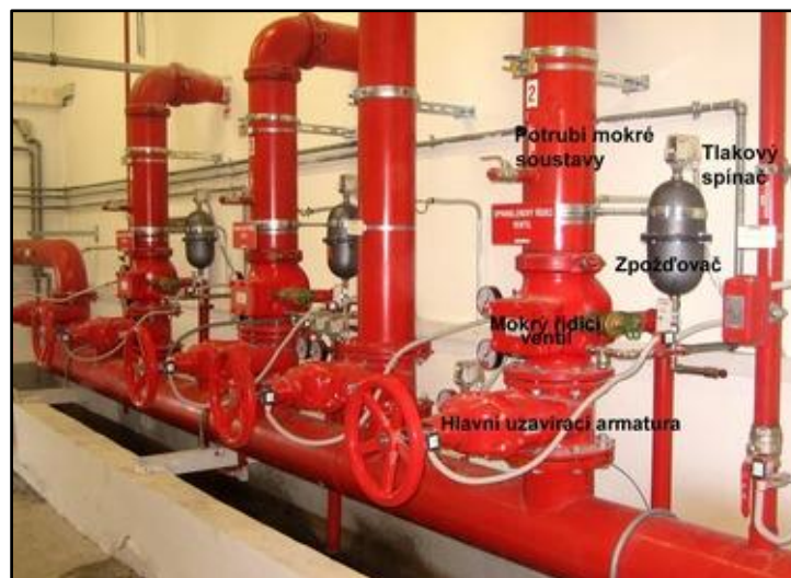
Obrázek 12: Strojovna s ventilovými stanicemi 25
