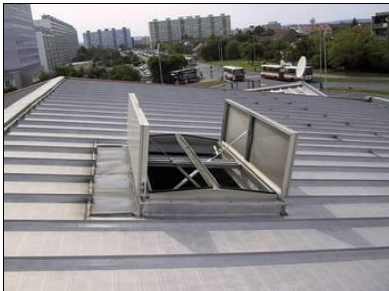
Obrázek 7: Zařízení na odvod kouře a tepla 17
