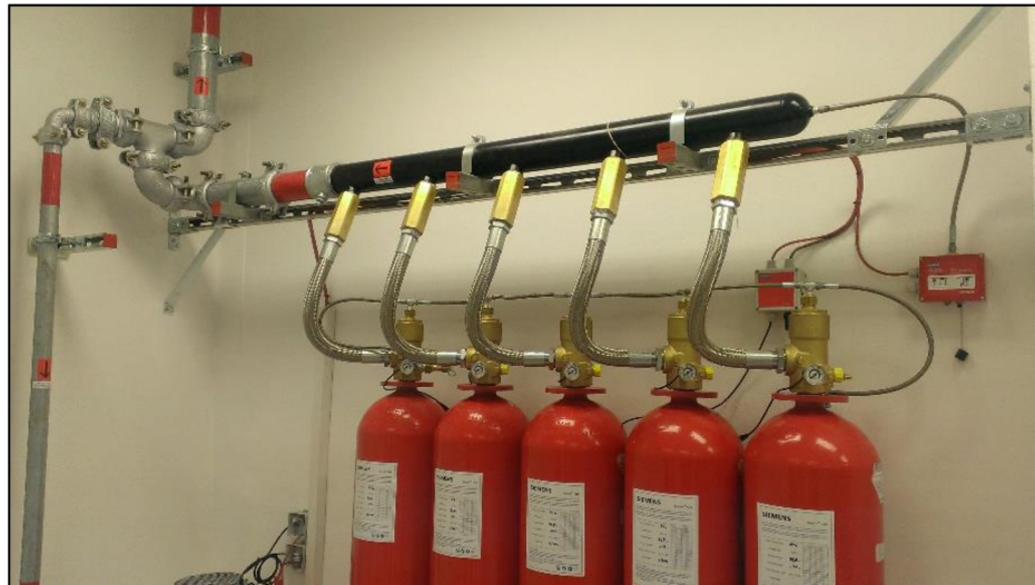
Obrázek 20: Záběr na tlakové nádrže s hasebním médiem 36
