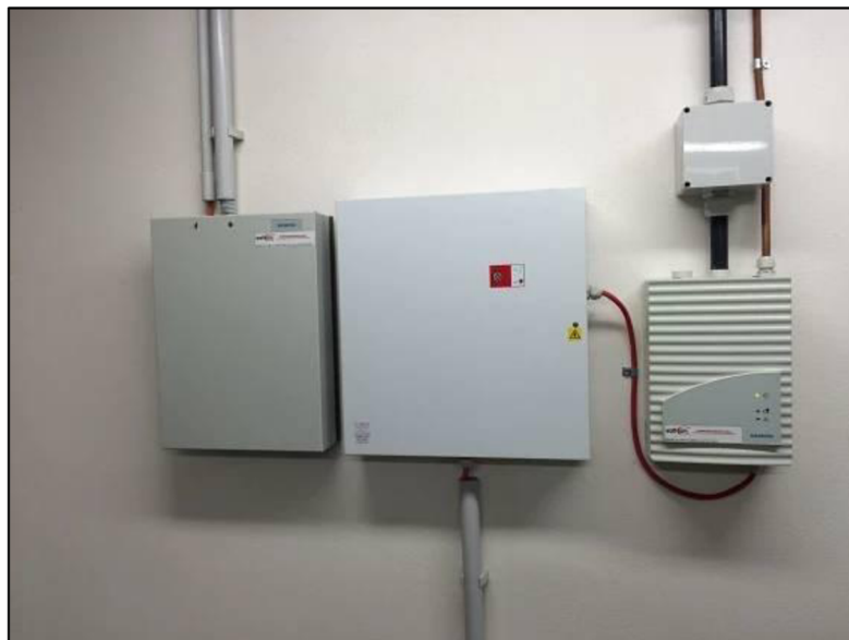
Obrázek 5: Ústředna elektrické požární signalizace 12
