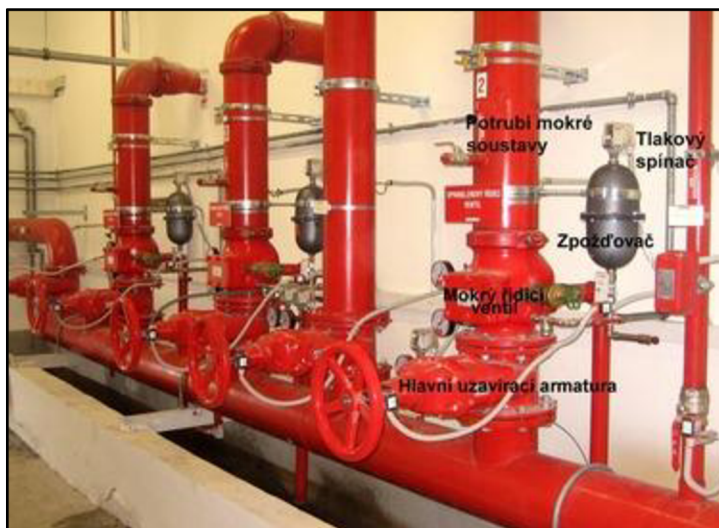
Obrázek 12: Strojovna s ventilovými stanicemi 25
