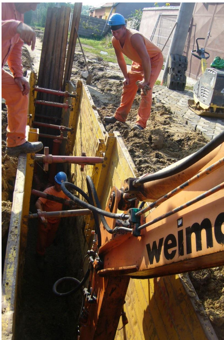
Obrázek 15 - Nezajištěný okraj výkopu proti pádu osob do výkopu, zdroj: vlastní
