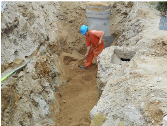
Obrázek 8 - Nezajištěný výkop, zdroj: vlastní
