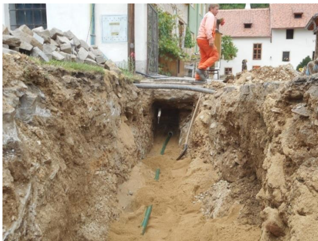
Obrázek 9 - Nezajištěný výkop, zdroj: vlastní
