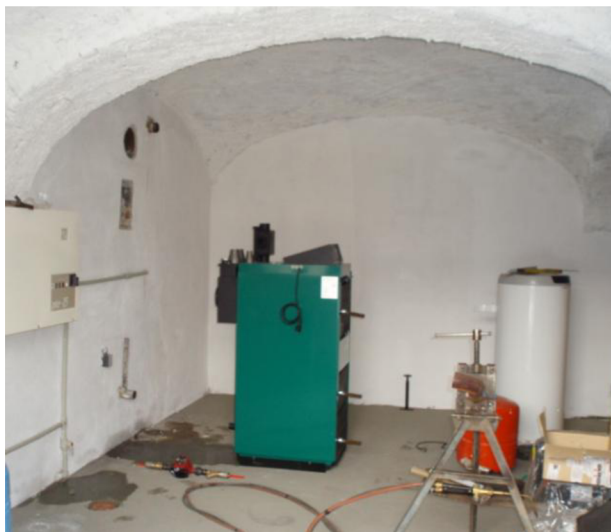
Obrázek 24 - Kotelna při rekonstrukci [vlastní]
