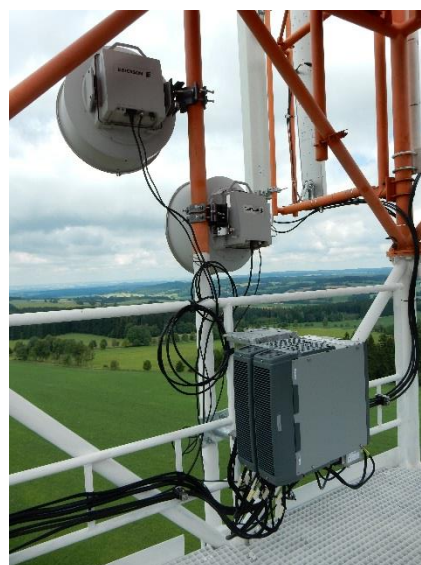
Obrázek 30 – Outdoor instalace FRMA [5]
