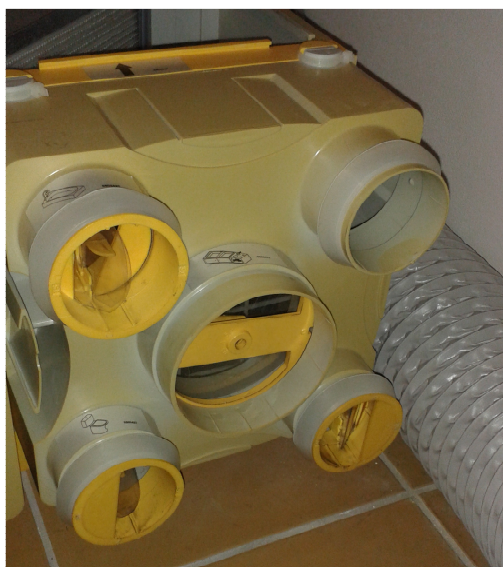
Obrázek 44 Hrdla pro odvod vzduchu z místnosti
