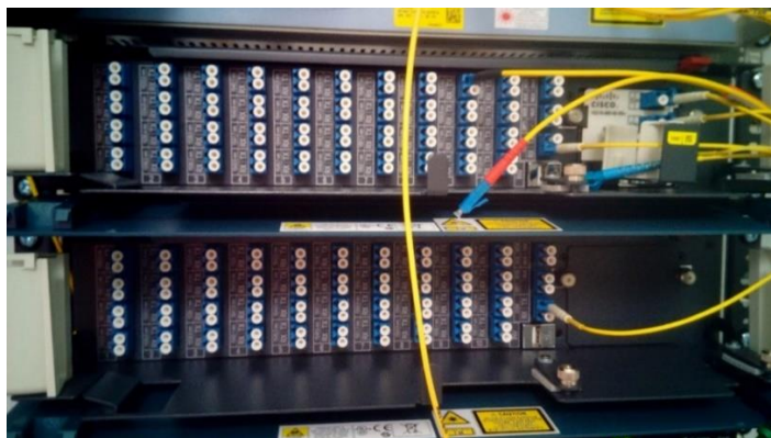
Obr. 5.5: Názorné zobrazení připojení měřicích optických přístrojů – generátoru KEOPSYS a spektrálního analyzátoru OSA – na optický patch panel s ukončením optických obou tras.
