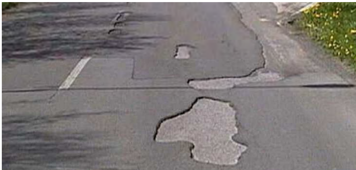
Obrázek 6 Příklad výtluku v obrusné vrstvě [37]
