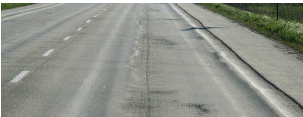
Obrázek 4 Příklad vyjetých kolejí v asfaltových vrstvách vozovky [37]
