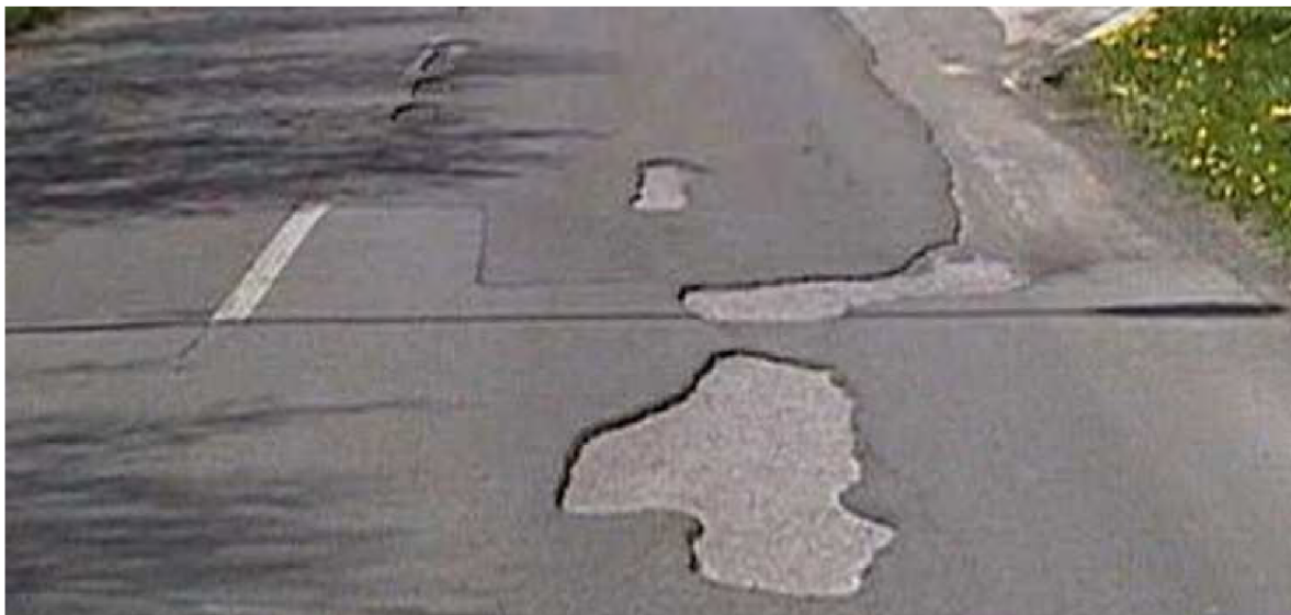
Obrázek 6 Příklad výtluku v obrusné vrstvě [37]
