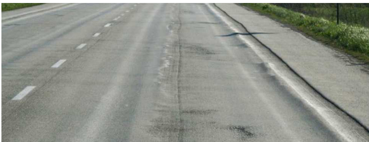
Obrázek 4 Příklad vyjetých kolejí v asfaltových vrstvách vozovky [37]
