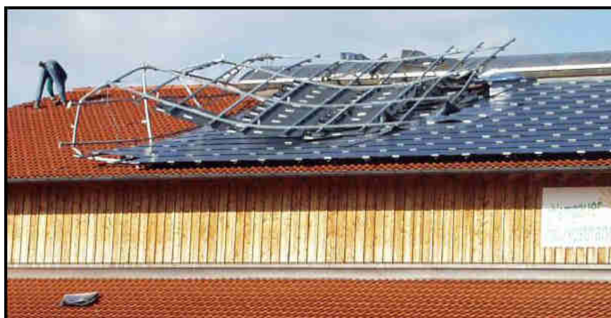
Obr. 2.3-2 FV elektrárna poškozená účinky větru [18]
